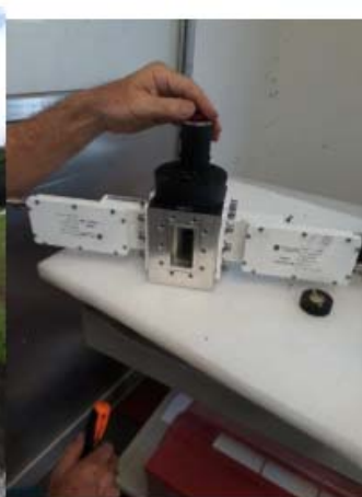
Verificación componentes Rx antenna
