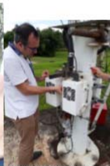
Instalación cooler IBUCs
